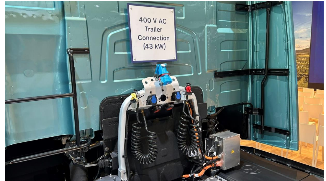
400 Volt – Schnittstelle (Wechselstrom) inklusive Kabelwendel installiert
